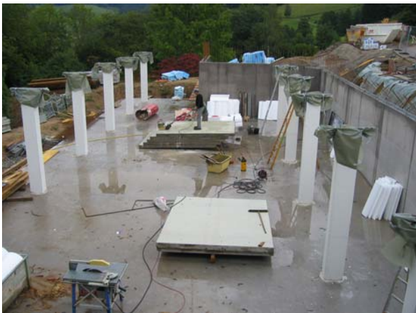
17. – 28.08.2006: die Wände sowie die Stützen werden gegossen / Casting of the walls and the columns
